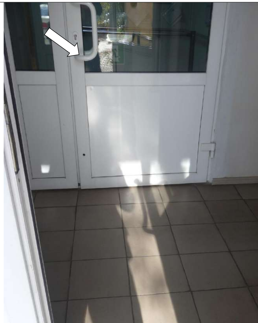
Фото № 4. Дверной проем и дверная ручка в тамбуре контрастно не маркированы.
