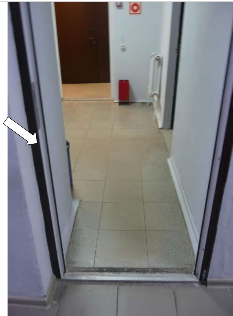
Фото № 6. Узкий дверной проем по пути движения к эвакуационному выходу
