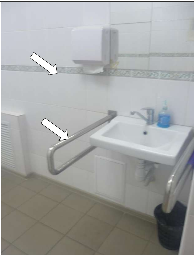
Фото № 11. Нет крючков для костылей возле умывальника. Опорные поручни возле умывальника не соответствуют требованиям нормативной документации
