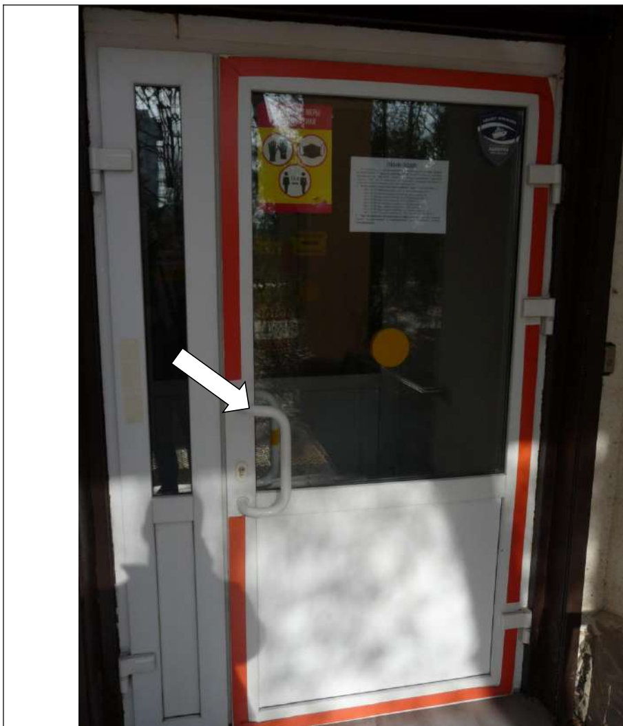
Фото № 3. Дверная ручка на входной двери контрастно не маркирована
