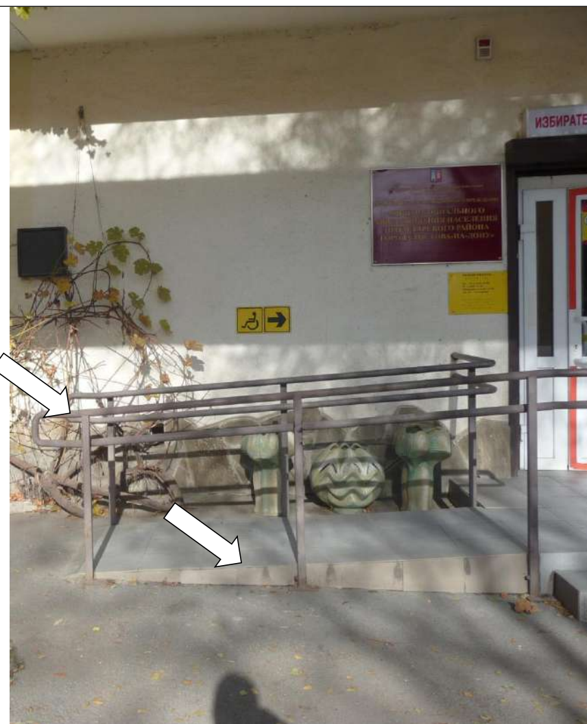
Фото № 2. Нет бортика по открытым краям марша пандуса. Поручни не соответствуют нормативным требованиям
