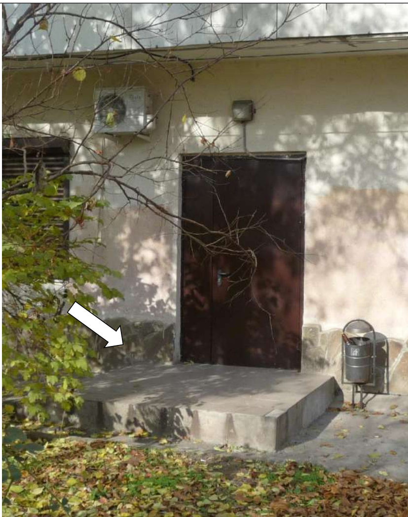
Фото № 5. Эвакуационный выход. Нет поручней на лестнице, ограждения входной площадки.
