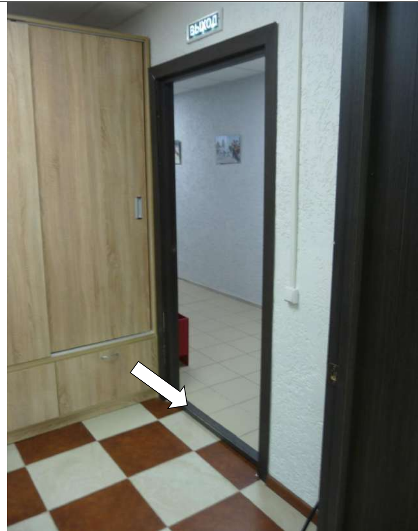
Фото № 8. Порог в дверном проеме на входе в тренажерный зал
